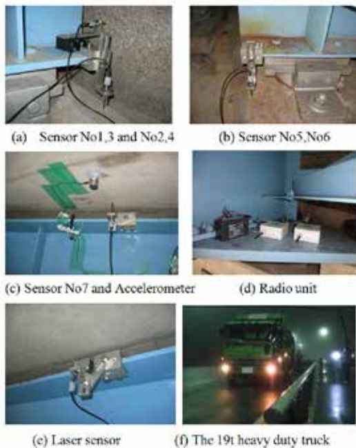
Figura 9: Detalle de instalación de sensores
